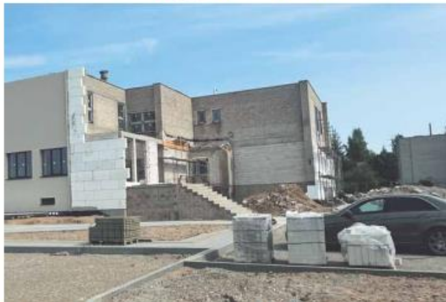
VšĮ Pagėgių pirminės sveikatos priežiūros centrui (PSPC) priklausančiose patalpose darbai pradėti dar 2022 metų balandžio 14 dieną.
